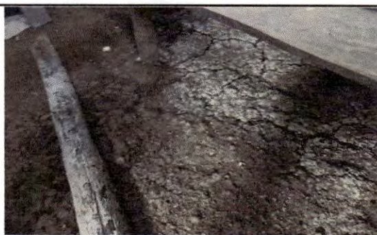
Foto 11: Piso quebrado en interior de cocina.
