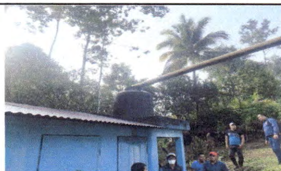
Foto 5: Canal de agua, PVC, en mala condición.
