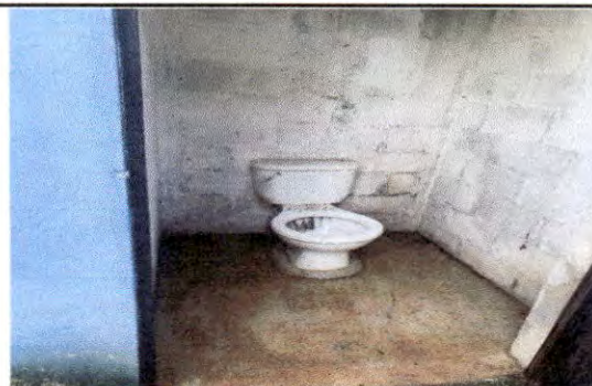
Foto 2: Piso en area de baños rajado.
