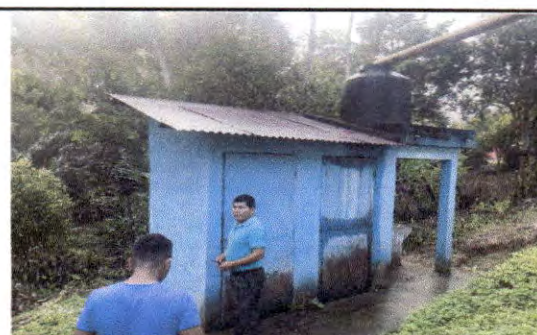
Foto 6: Sanitarios con filtraciones de humedad.
