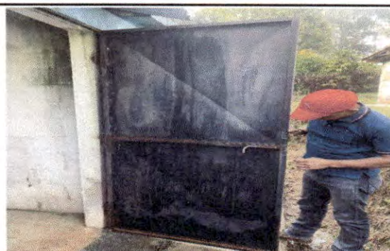
Foto 8: Puertas oxidadas y en condición depreciable.
